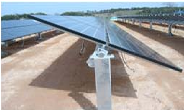
Fig. 3-2 Variable fixed PV array
