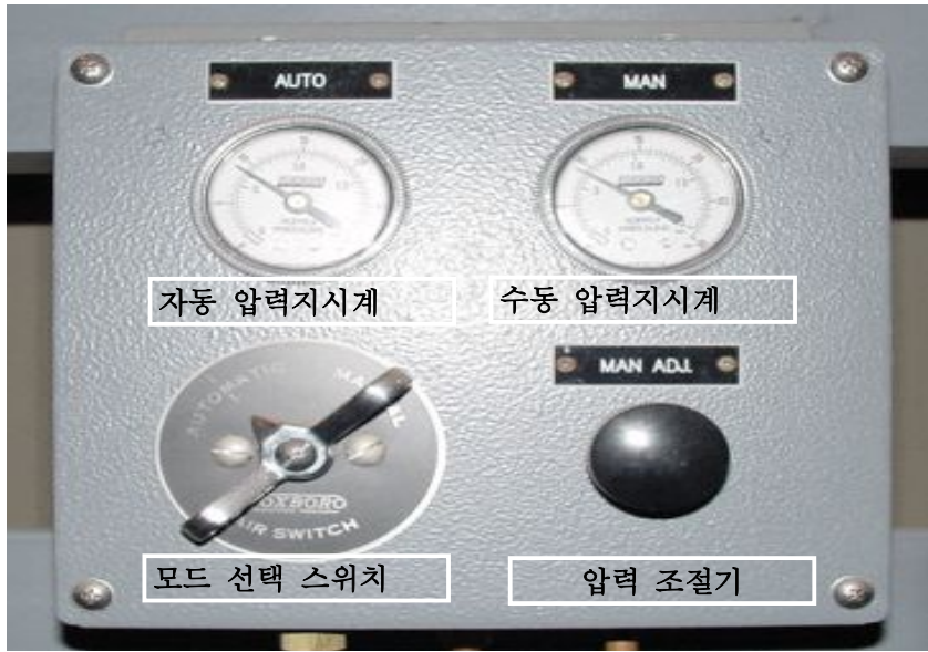
그림 4-3-2 영광5, 6호기 M/A Station 현장 사진
