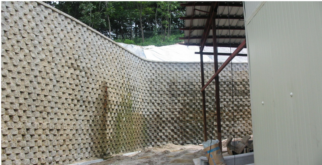
그림 2.11 계곡부에 설치된 보강토옹벽의 지하수 누출현상
