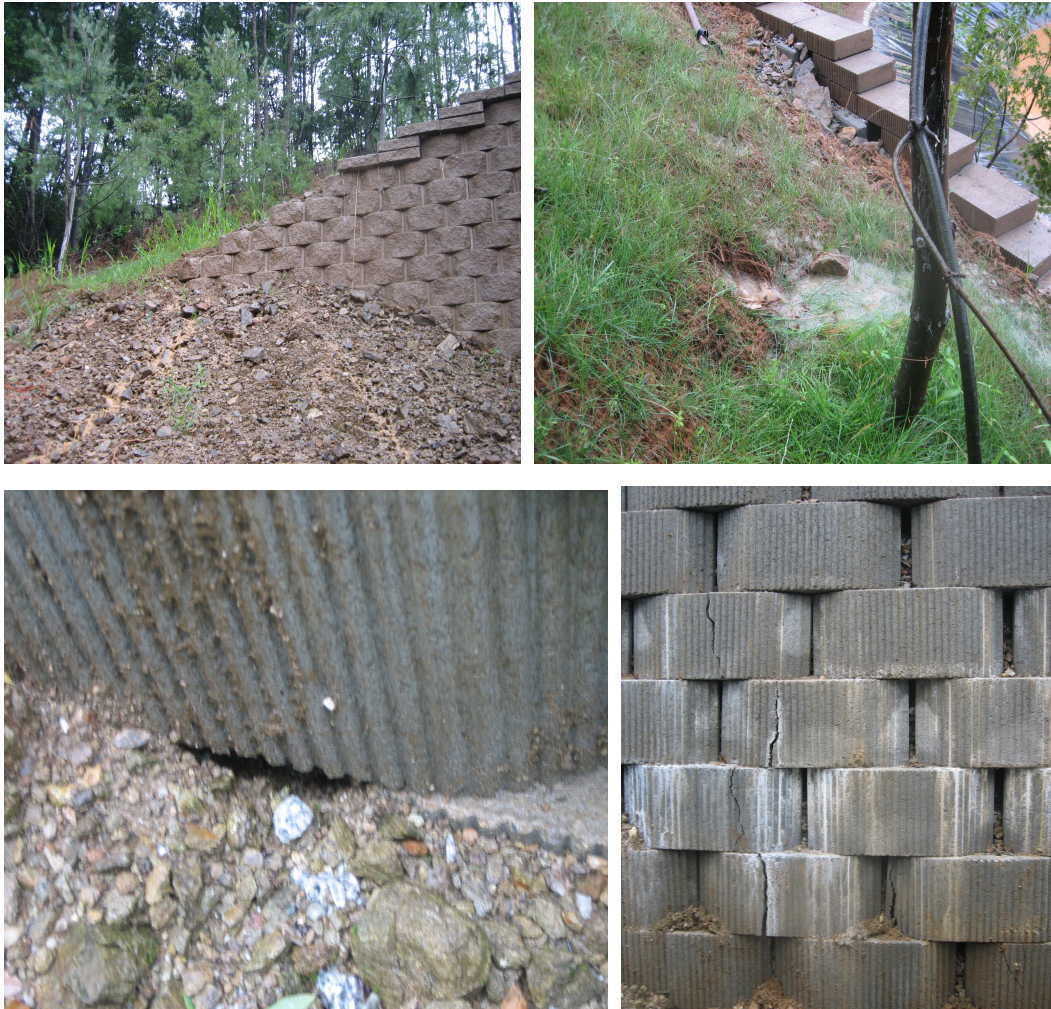
그림 2.16 E현장(경기도) : 유입된 지표수로 인한 기초부 세굴 및 침하발생
