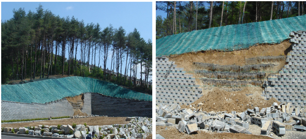
그림 2.14 C현장 (강원도) 벽체상부 붕괴현장 : 강우시 지표수 유입
