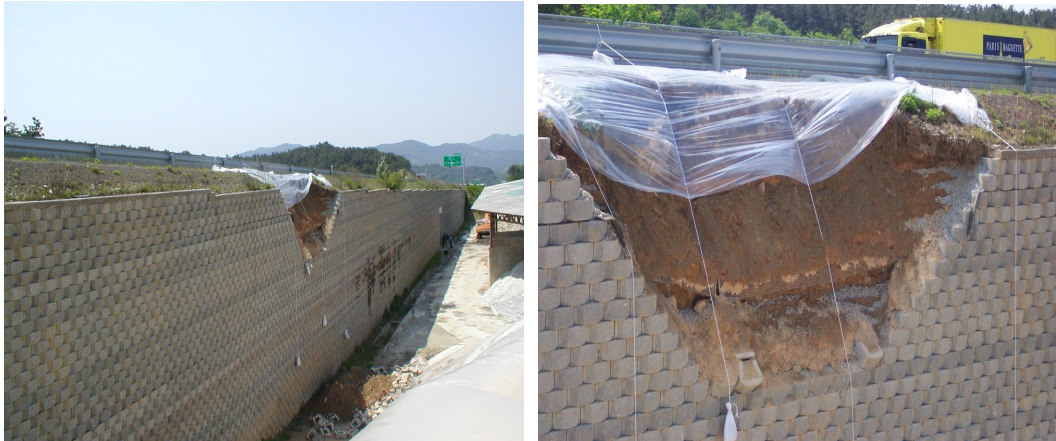
그림 2.12 A현장 (전라도) 벽체상부 붕괴현장 : 뒷채움토사 불량
