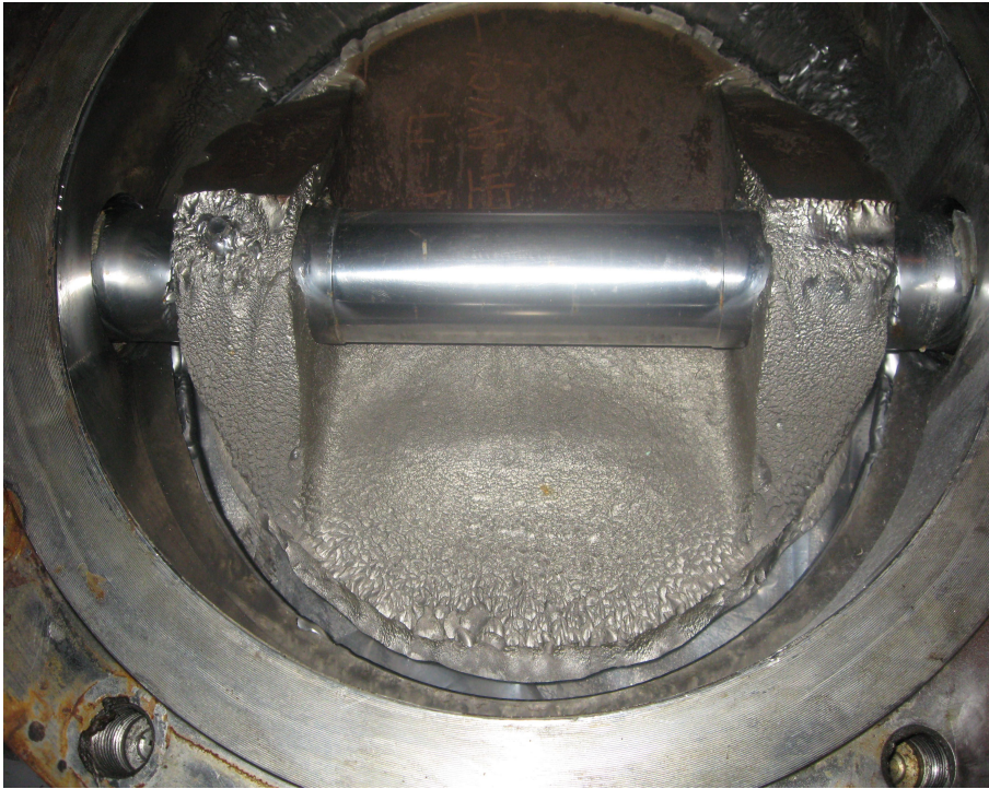
그림 3.1.1 1차기기 냉각해수 유량조절밸브 침식 손상 사진(B)
