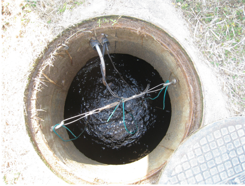
(a) Y시 마을하수도 방류수 맨홀에 설치된 자외선 램프
