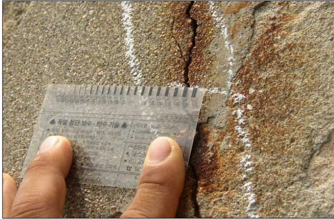
사진 3.4 균열 발생 현황
