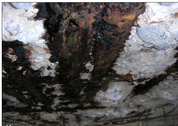
사진 3.2 부두 하부 철근부식
