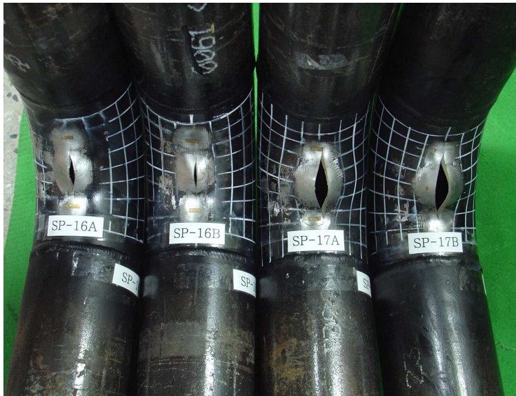
b) 내호면 결함(Intrados defect)
