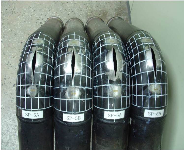
a) 외호면 결함(Extrados defect)
