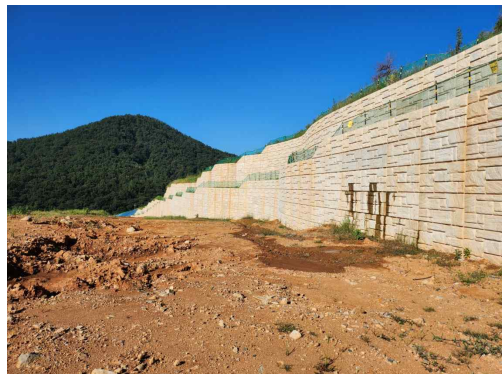
(f) 옹벽 전면 우수 유출
