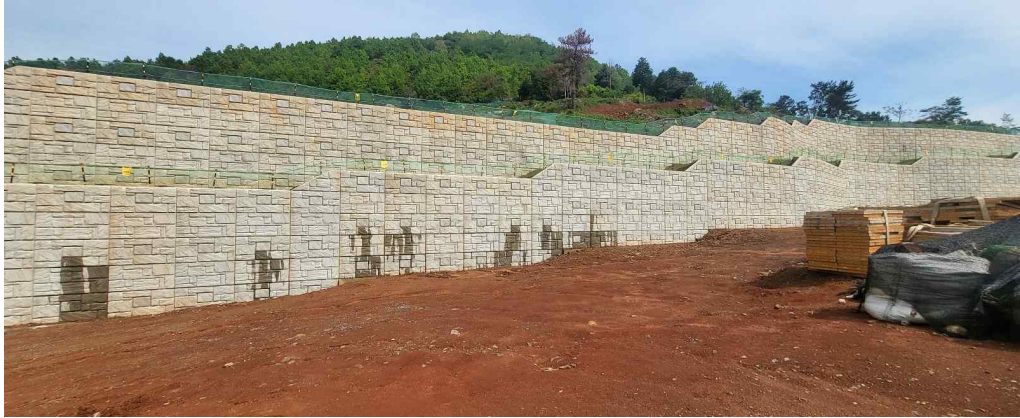
(g) 옹벽 전면 우수 유출
