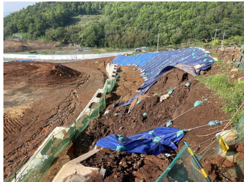
(b) 우수유출로 인한 침하 및 균열
