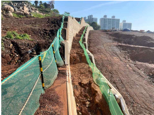
(a) 우수유출로 인한 침하 및 균열
