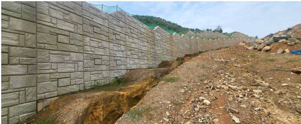
(h) 옹벽 전면 우수 유출
