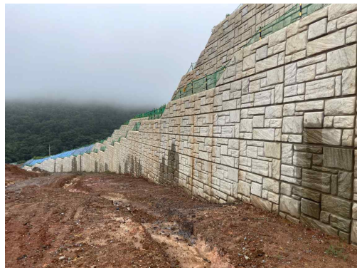
(d) 옹벽 전면 우수 유출
