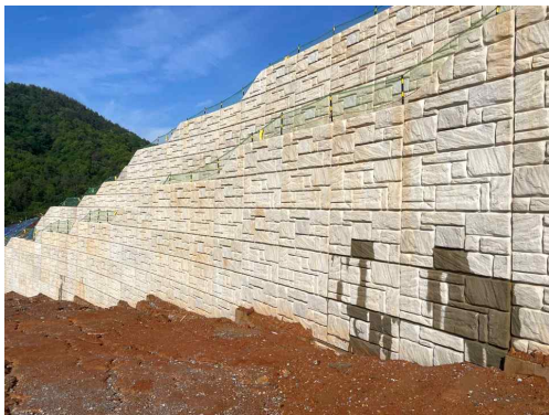
(c) 옹벽 전면 우수 유출
