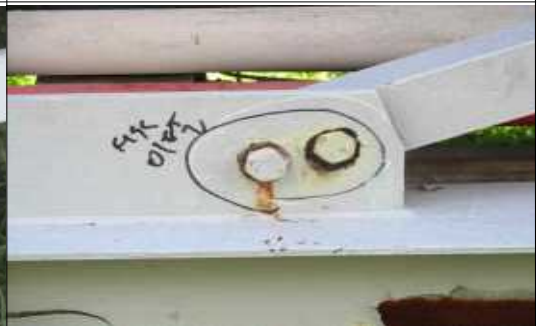
수직가새 접합볼트 파손
