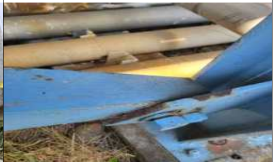
V.Brace 볼트 풀림 상태
