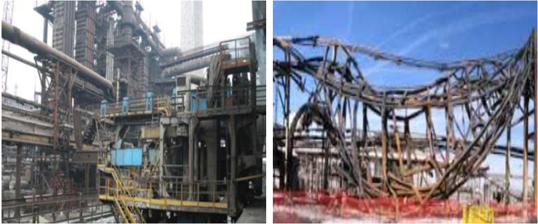
그림 1.2 파이프랙 노후화 및 붕괴 사례
