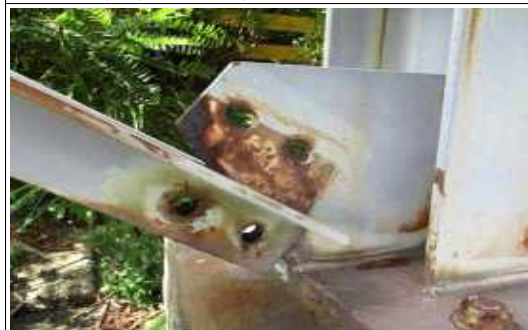
수직가새 볼트 탈락
