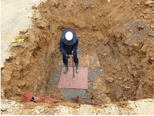
(a) 계측기 매설 전경(1)
