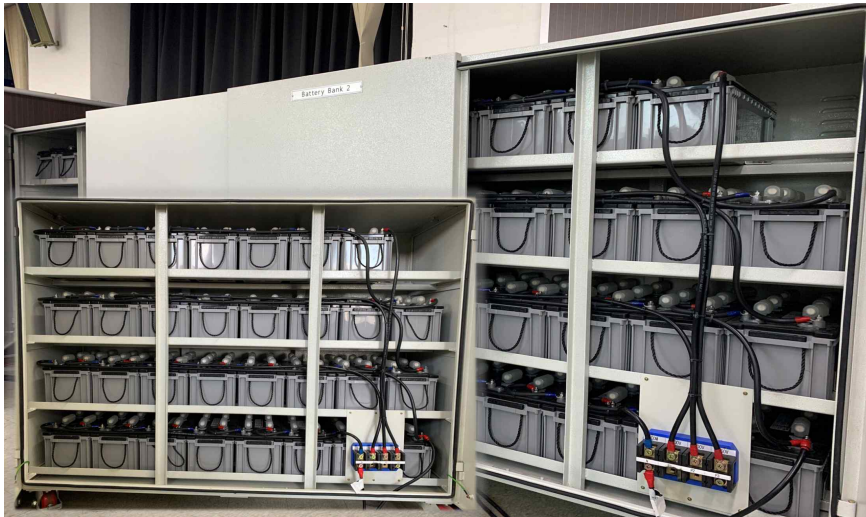
그림 4-1 DC 배터리 뱅크 1, 2 Fig. 4-1 DC battery banks 1 and 2
