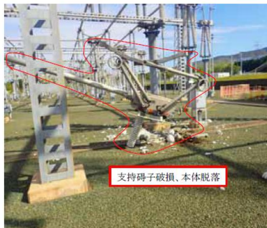
【支持碍子破損、本体脫落】
