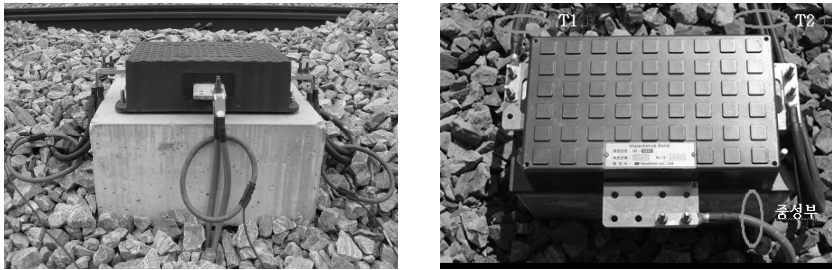
[그림 30] 노안역 인근 임피던스 본드 및 센서 설치
