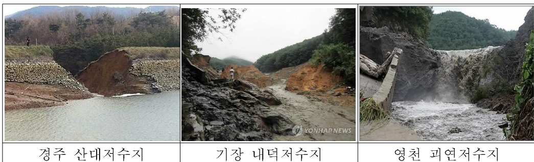
Fig. 1-1. 붕괴사고가 발생한 농업용 저수지
