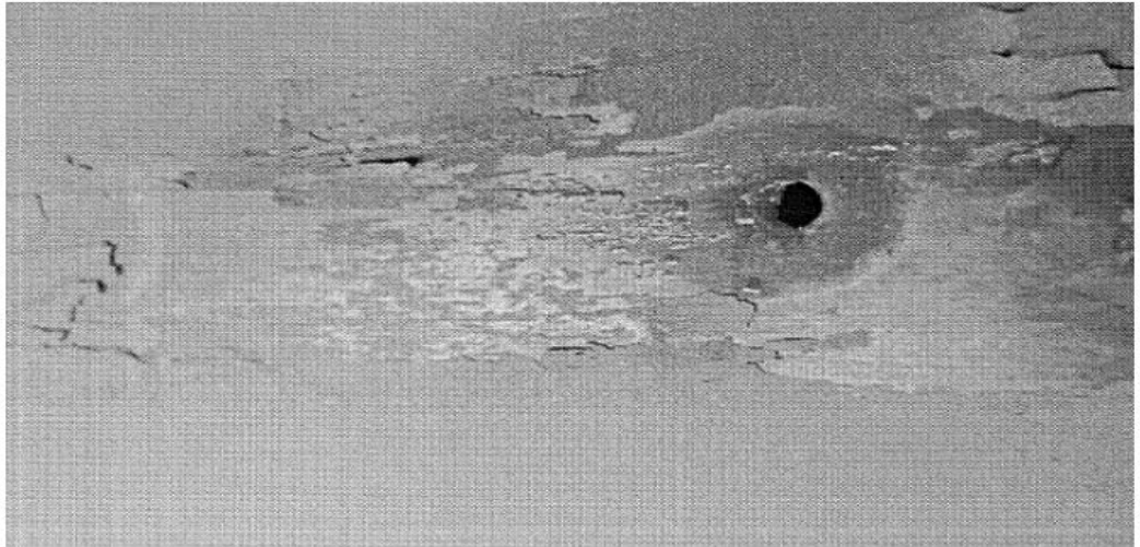
그림 5.1 한빛 5호기 벤츄리 노즐 내부 상태
