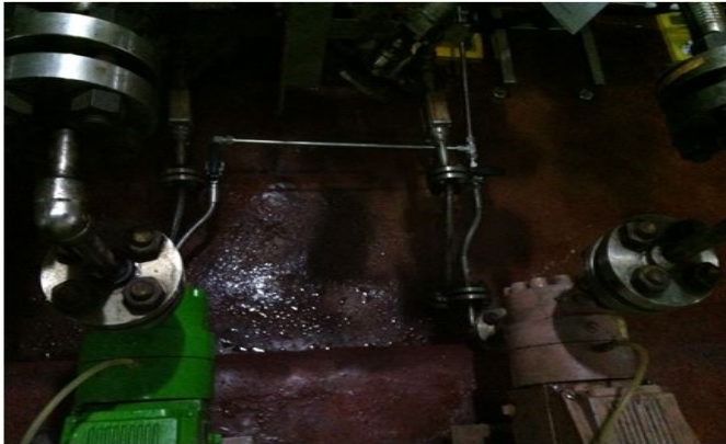
그림 3.3 약품주입펌프 및 배관 연결
