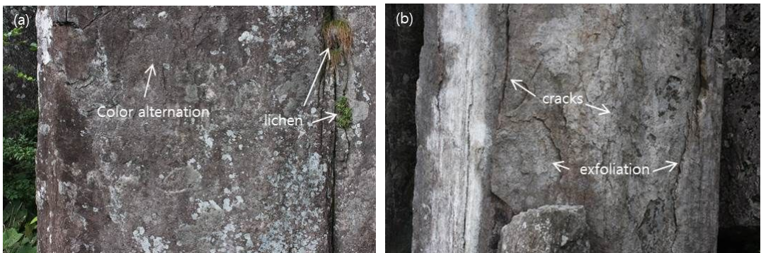
그림 6.1 입석대 주상절리대 표면상태, (a) 변질 및 식생 (b) 균열 및 박리박락
