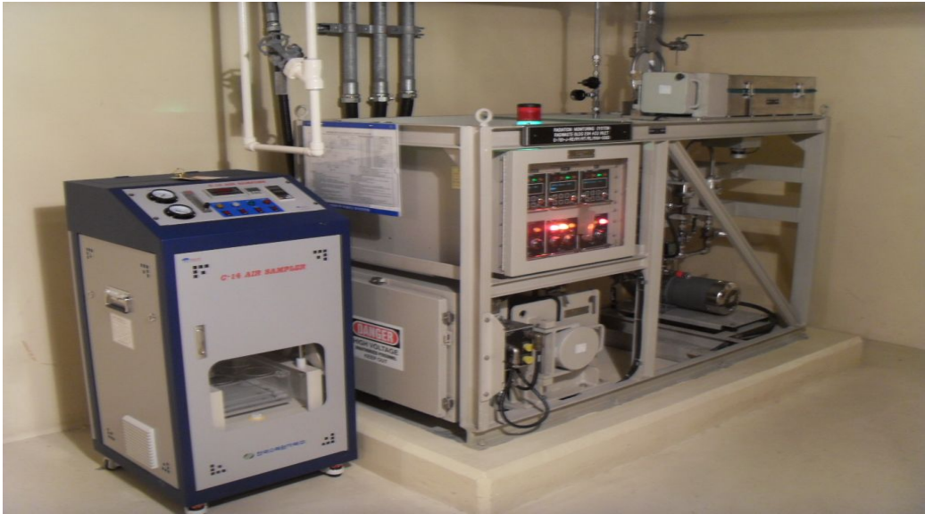
[ 그림 5.1 ] ^{14}\text{C} 포집장치 설치 사진(한빛 제3발전소)
